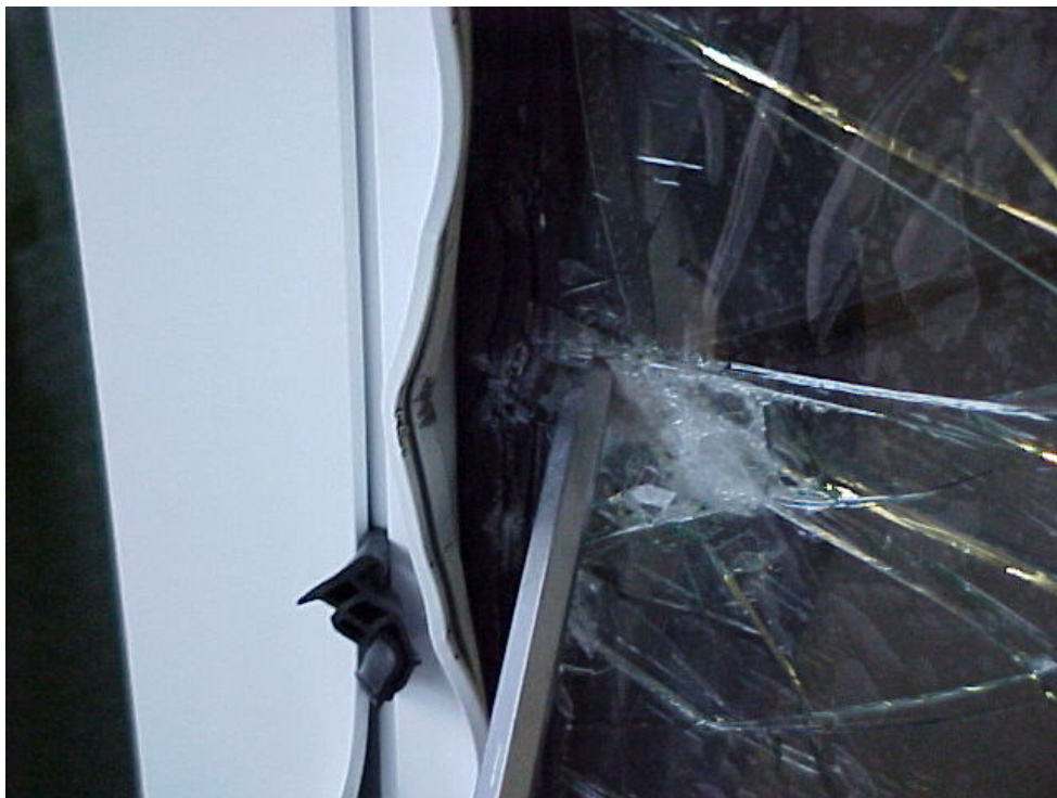
Bild 4 Schäden aus der manuellen Prüfung an der Glasanbindung
